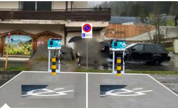
A Morgins, des bornes de recharge seront prochainement installées sur la place du 6 Août.
